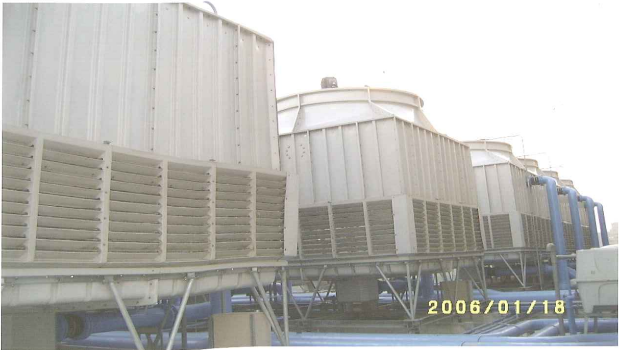
冷卻水塔：5700RT
