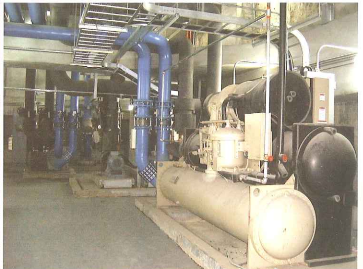
冰水主機：700RTx1 台
