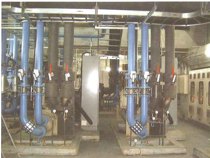
冰水主機：150RTx2 台
