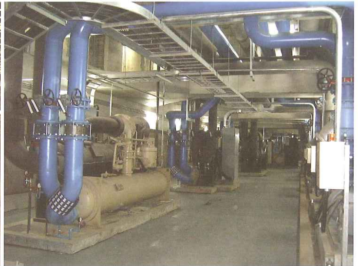
冰水主機：700RTx2 台
