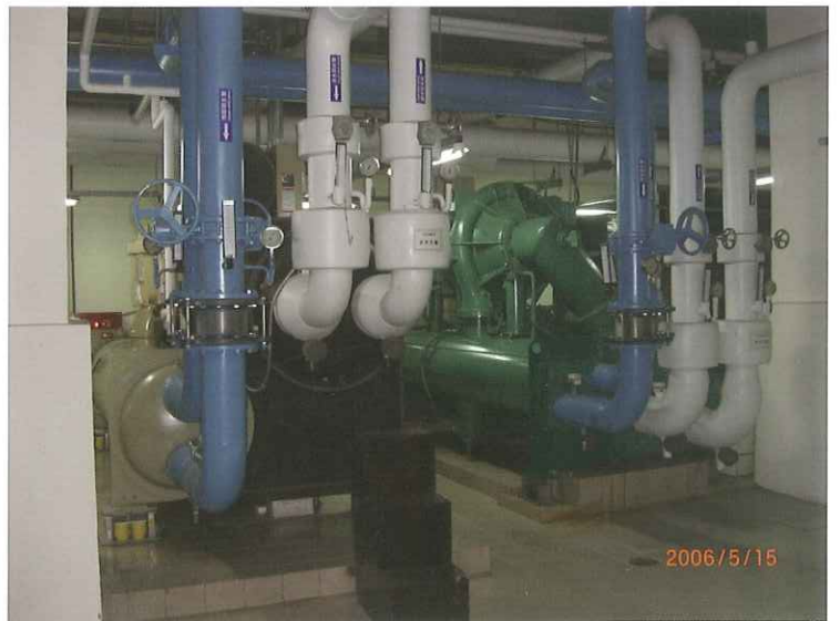
冰水主機：500RTx1 台、 350RTx1 台、250RTx1 台
