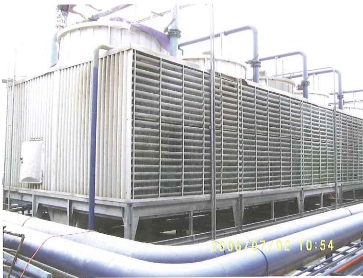
冷卻水塔：900RTx3 台 600RTx1 台
