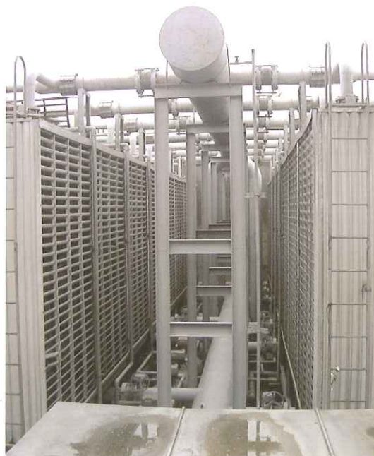
冷卻水塔：4000RT 台
