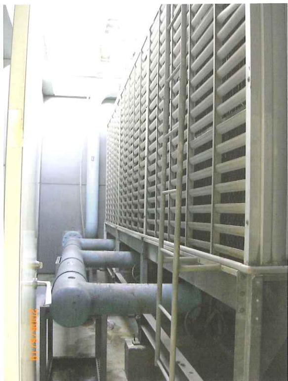
冷卻水塔：800RT
