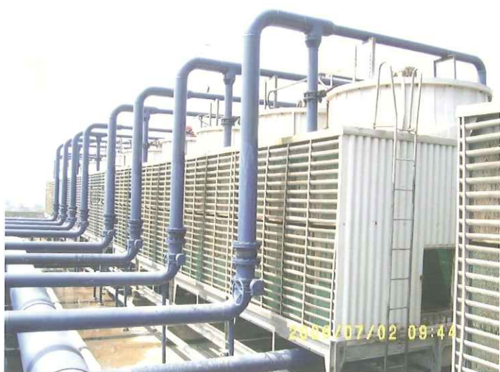
冷卻水塔：900RTx3 台 600RTx1 台
