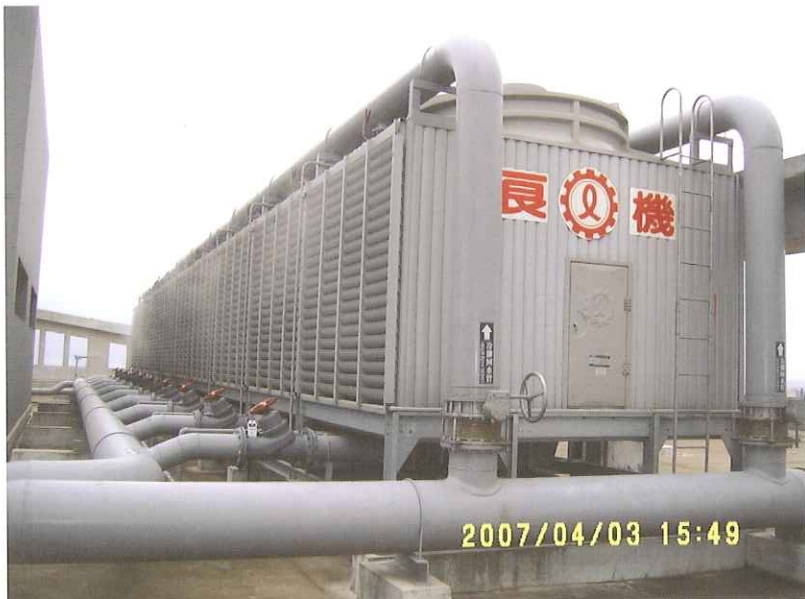
冷卻水塔：1800RT
