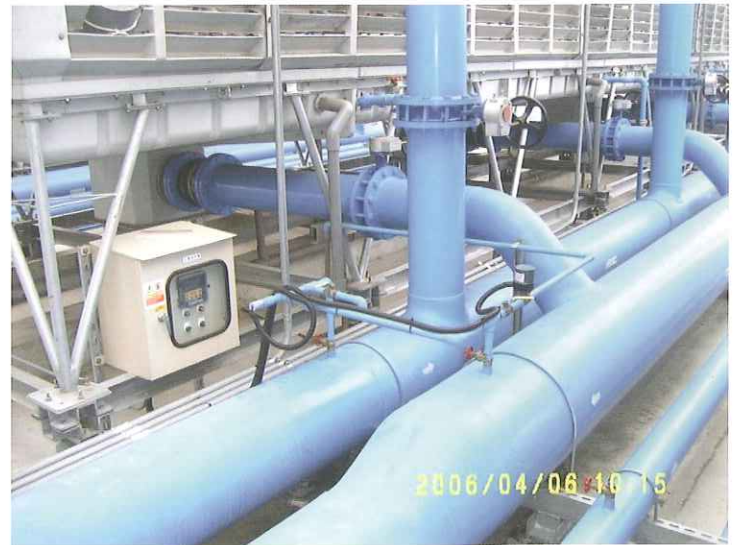
電導度自動控制排放系統
