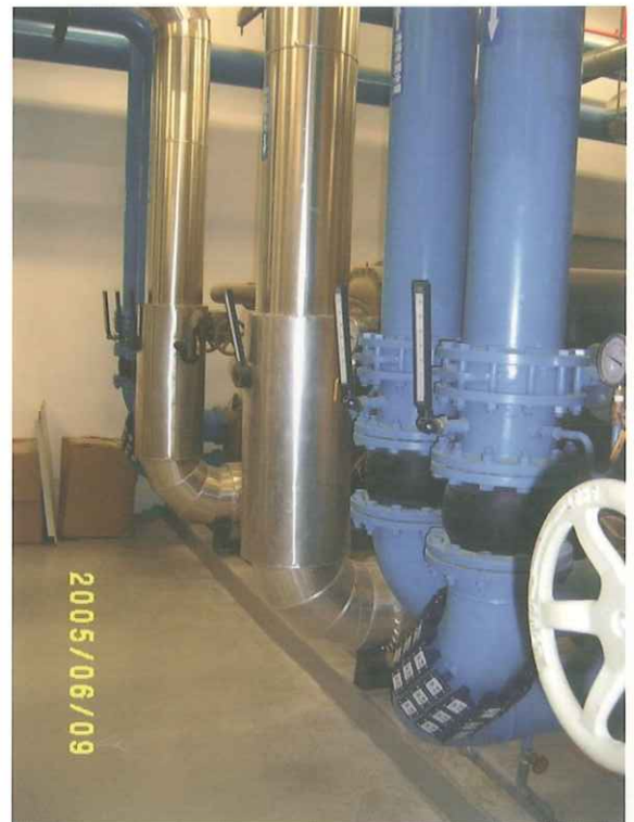
冰水主機：320RTx2 台
