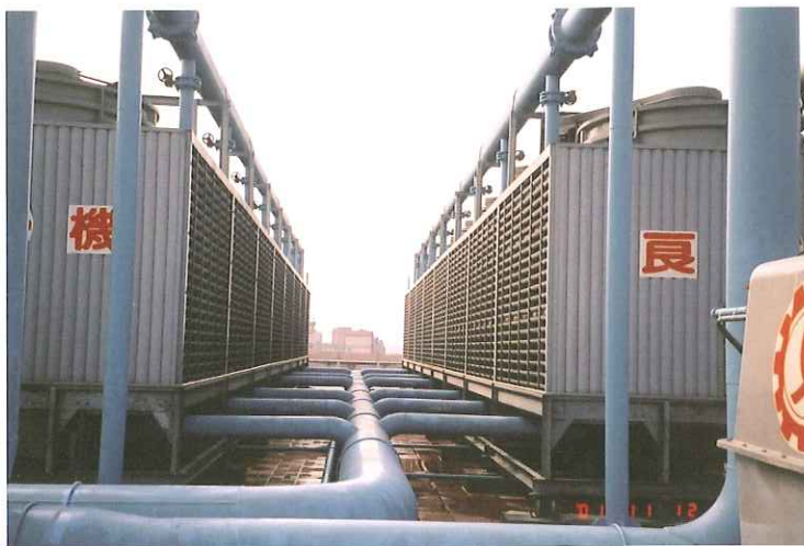
4000RT 冷卻水塔
