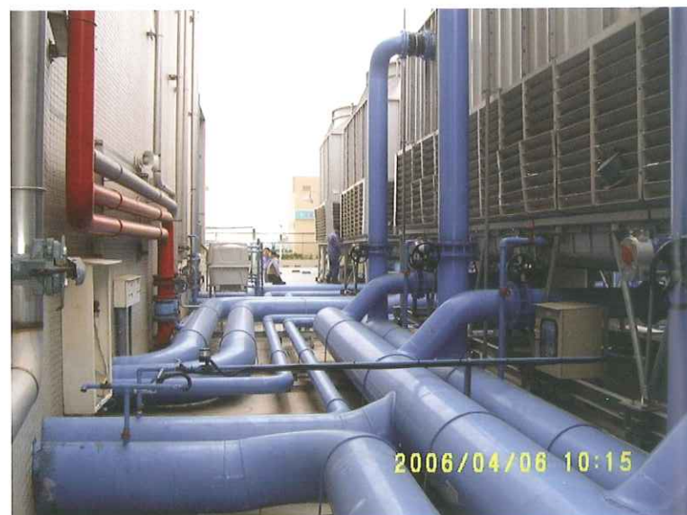
冷卻水塔：共 5700RT
