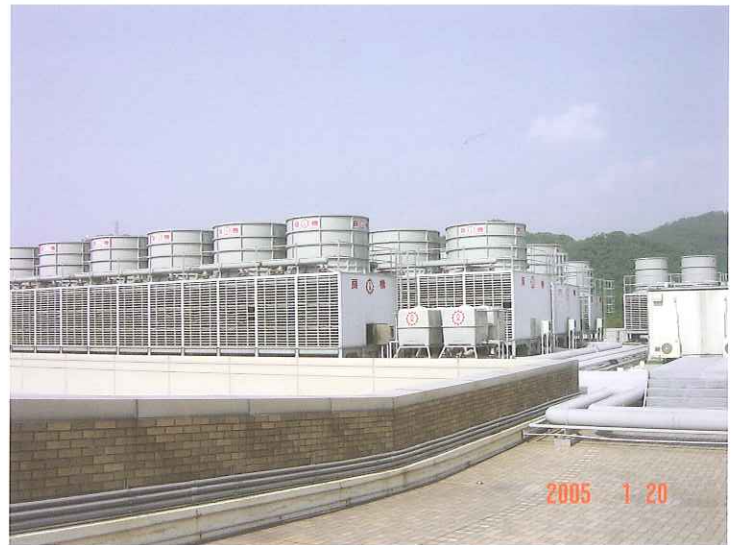
冷卻水塔：共 10000RT
