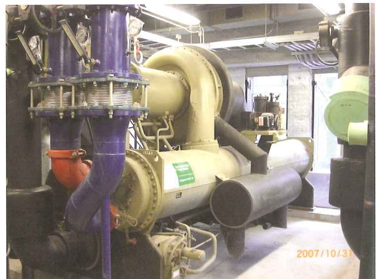
冰水主機 550RTx2 台、200RTx1 台
