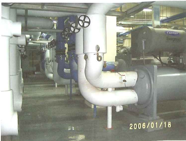
冰水主機：800RTx4 台/600RTx2 台 冰水主機：225RTx1 台/300RTx1 台
