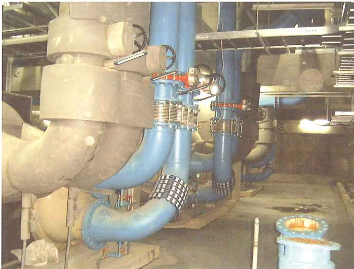
冰水主機：1000RTx3 台/1250RTx2 台
