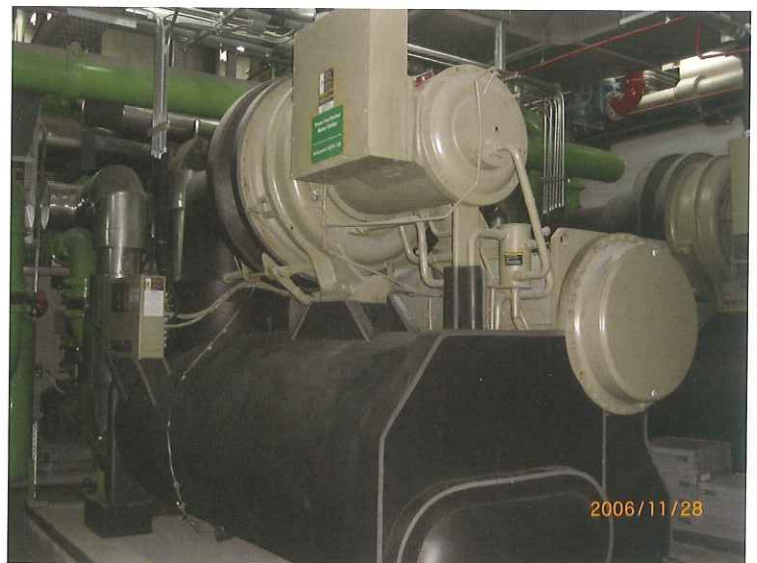
冰水主機 450RTx2 台、300RTx4 台
